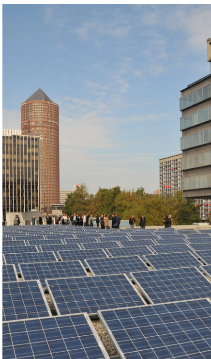
Panneaux solaires, Communauté urbaine de Lyon
